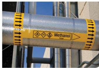
Marqueurs de tuyauteries
